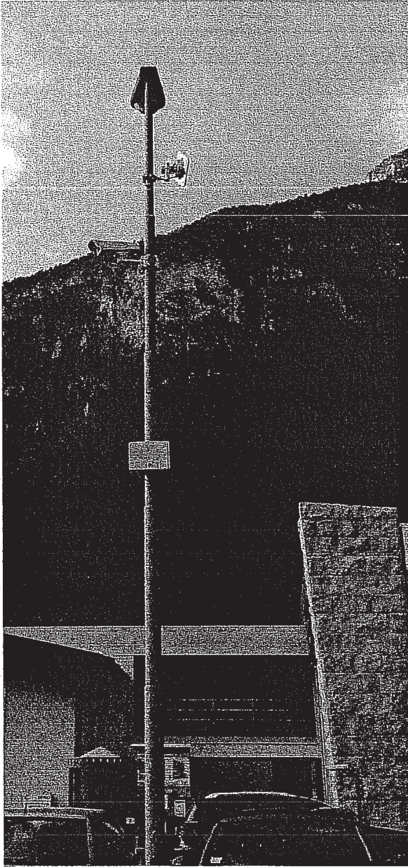
Questa immagine è un esempio di come si presenta l'installazione su un palo della pubblica illuminazione.
